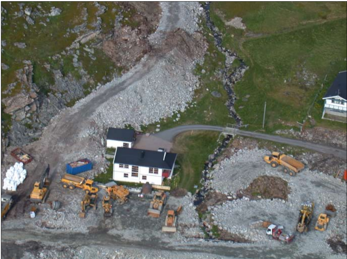
Fig. 5.10 Meland. Lokaliteten Meland Nedre ligger på oversiden av veien, til venstre for elva og nedenfor kampesteinen midt i bildet. Anleggsarbeidet er godt i gang på dette tidspunktet. Foto: Melkøyprosjektet©Tromsø Museum Universitetsmuseet
