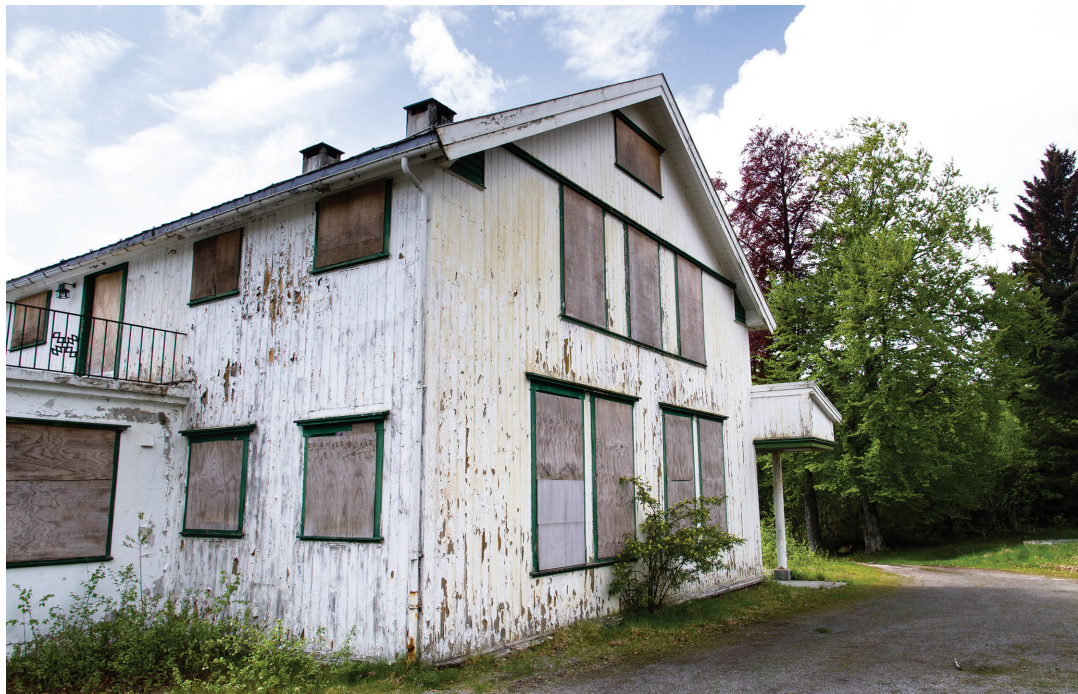
Figur 9. Den nordvendte baksiden av Villa Retiro. I dag er nesten alle vinduene til bygningen blitt dekt over med sponplater og malingen har begynt å prelle av. Foto: Stein Farstadvoll, mai 2015.
