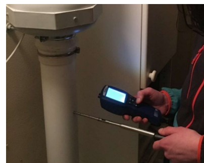
Figur 5.2.1-1. Måling av luftmengde.
