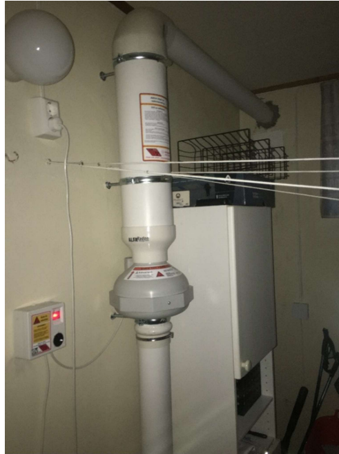
Figur 4.2.2-1. Den gamle radonbrønningen. Viser den gamle viften og kanalen til avkast ut veggen.
