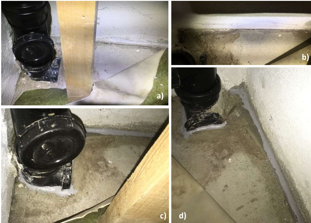
Figur 5.1.2-10. Tetting rundt gjennomføring i matkjeller. Se i figur 4.3.2-1 for plassering, a) belegg brettet bort; b) krympesprekk langs vegg; c) fuget rundt gjennomføring; d) fuget langs vegg.
