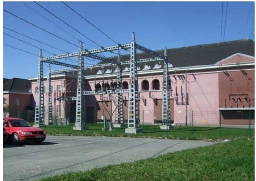
Figure 7: Station for transformation Store norske leksikon, Knut Rosvold (2014) Retrieved from: https://snl.no/transformatorstasjon
