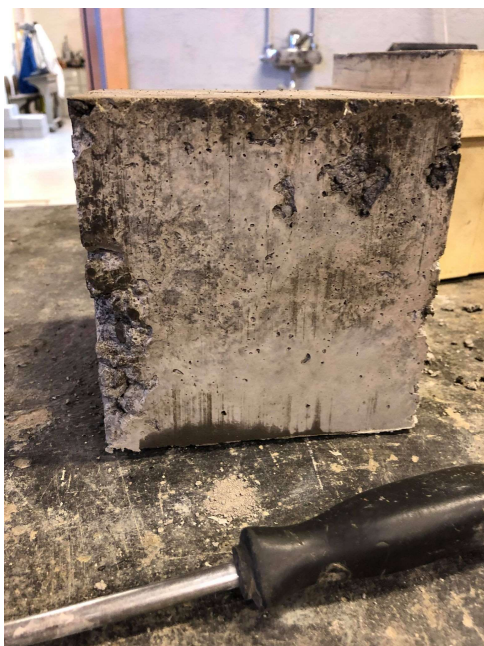
Bilde 7 Dårlig form/feil komprimert
