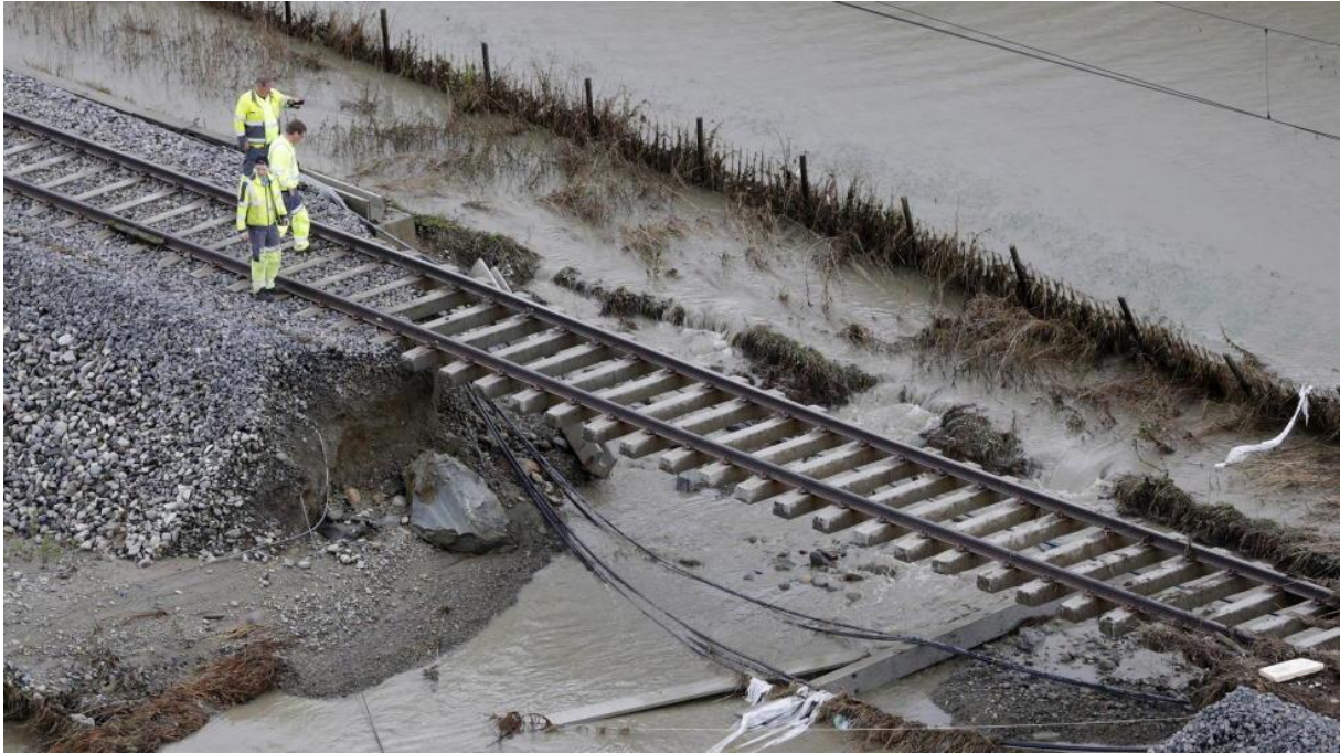
Bilde: Ødeleggelsen av infrastrukturen i forbindelse med flommen i Gudbrandsdalen 2011.
