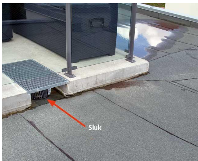
Figur 31: Eksempel på betongplate støpt direkte på tekingen som hindrer effektiv avrenning og vanskelig framtidig omteking (SINTEF, 2012).
