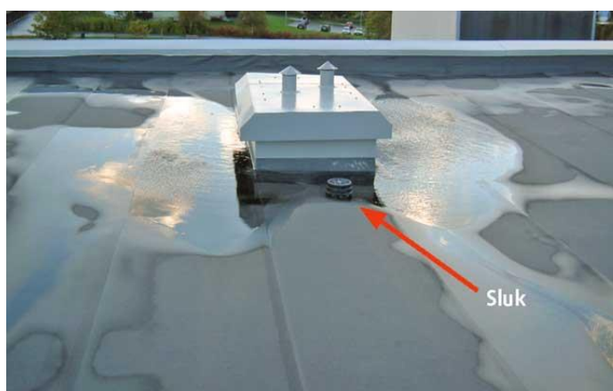
Figur 29: Eksempel på tak med for lite fall mot sluk og hindringer, som fører til vanddammer (SINTEF, 2012).
