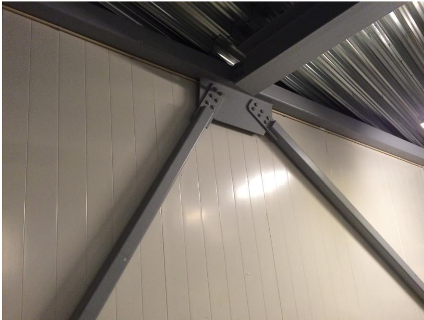
Figur 68: Innsiden av fasade i teknisk rom 1 hvor vann har blitt observert rennende nedover (Foto: Martin Jonassen Fjelde)
