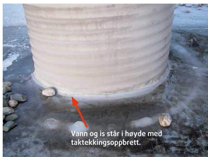
Figur 34: Eksempel der is har lagt seg rundt gjennomføringen i høyde med takfoliens oppbrett og fører til fare for lekkasje ved at limforbindelsen svikter. Ved høyere fall og oppbrett ville risikoen for lekkasje ha minsket betydelig (SINTEF, 2012).
