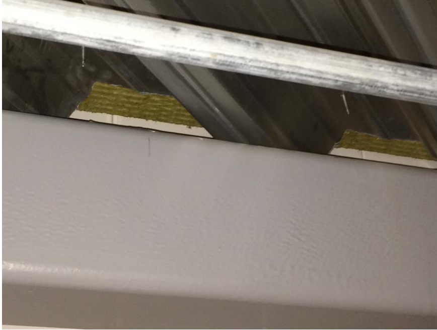
Figur 67: Overgang mellom kompakt tak og sandwichelement hvor det er blitt observert fukt (Foto: Martin Jonassen Fjelde, 2016)
