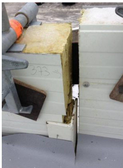
Figur 50: Bildet viser stor spalt mellom to elementer som heller ikke er tildekket mot fuktinntrengning (Noreng, 2015).
