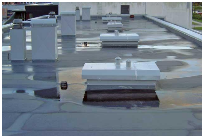
Figur 30: Eksempel på tak der feilplassert sluk i forhold til gjennomføringer i taket gjør at vandammer oppstår rundt gjennomføringene (SINTEF, 2012).
