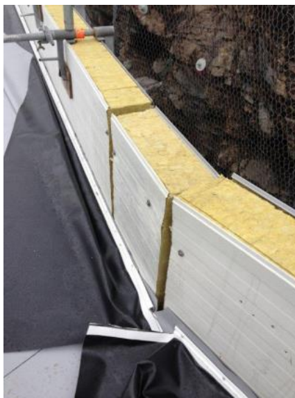
Figur 48: Bildet viser ufullstendig sprang og skjøter mellom elementene (Noreng, 2015).
