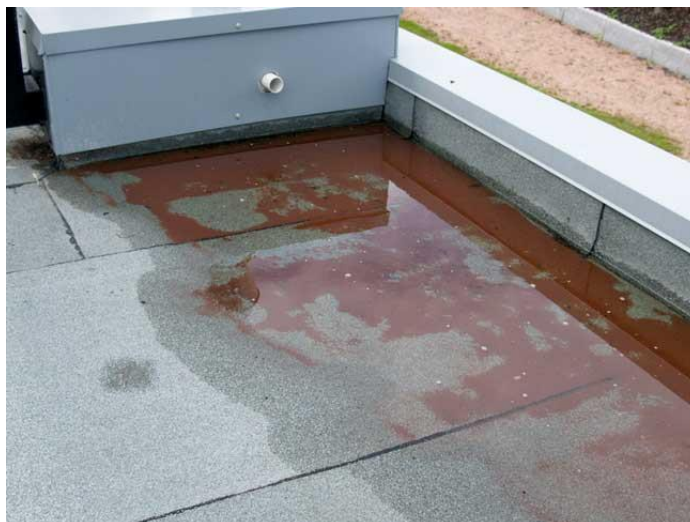
Figur 28: Eksempel på tak med manglende fall som fører til stående vanddammer som øker påkjenningen på tekningen (SINTEF, 2012).
