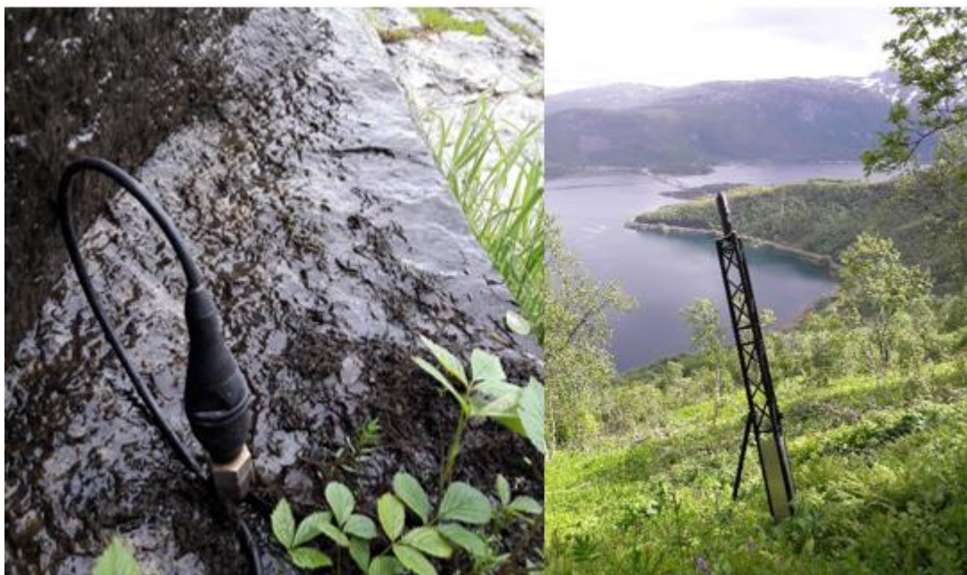
Figur 17. a) Geofon montert i berget med kabel til radiotårn. b) Radiotårn med prosesseringsenhet og trådløs overføring til styreskap ved veien. Begge bildene er tatt på befaring av forfatteren i Sandneslia sommeren 2017.
