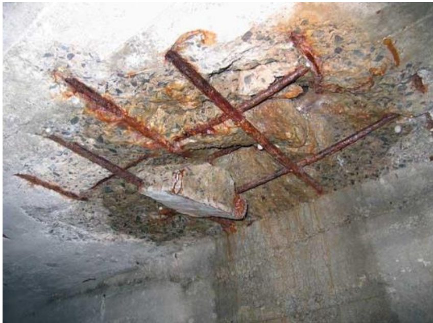
Figur 14 Korrosjon av armering [14]
