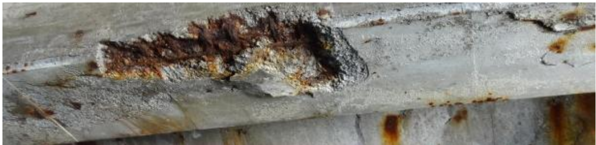
Figur 13 Synlig armering etter avskalling på bjelke (NATO kaia Olderdalen)
