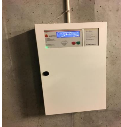
Figur 5-24 Branntavle bilder montert i mars 2018.
