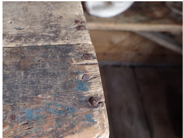
Figur 23: Sidestykke på lokket med synlige spiker.
