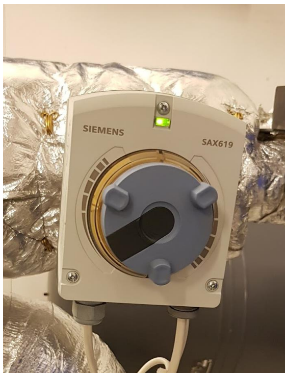
Figur 33 - Reguleringsventil på fjernvarmesentral.
