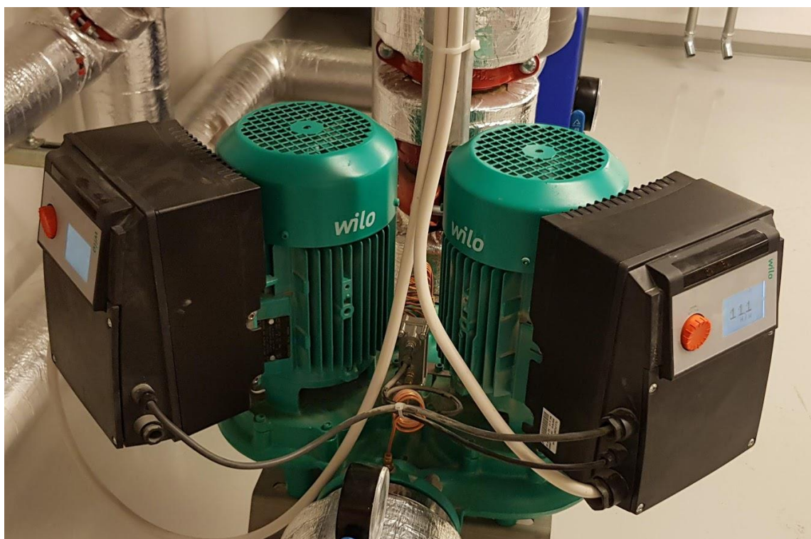
Figur 35 - Sirkulasjonspumpe plassert i system 320.01.
