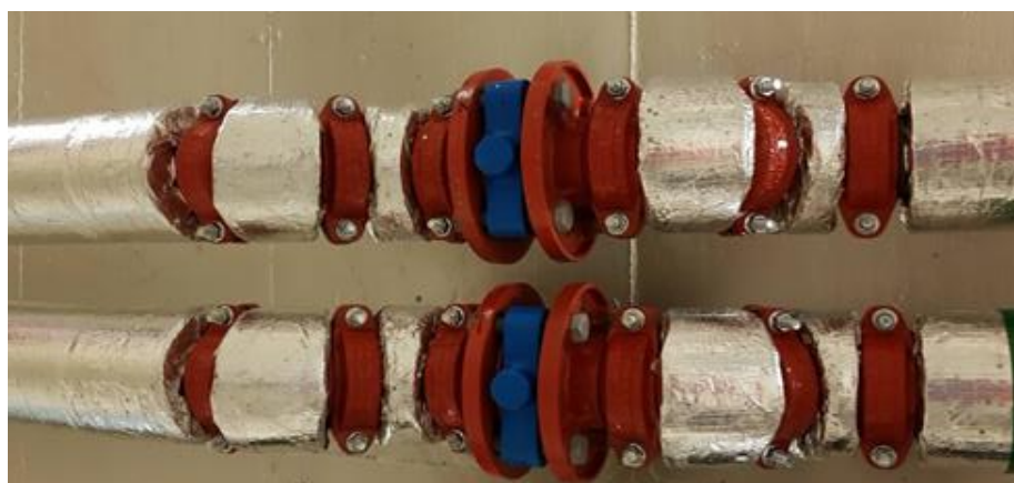
Figur 51 - Dokumentasjon av manglende isolering i parkeringskjeller.
