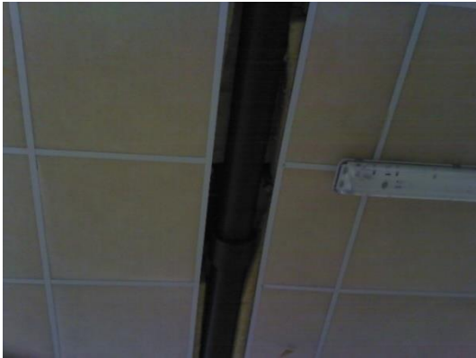
Figur 5.8. Fotografi av overvannsrør uten med manglende isolasjon (Foto: Emil Pettersen)
