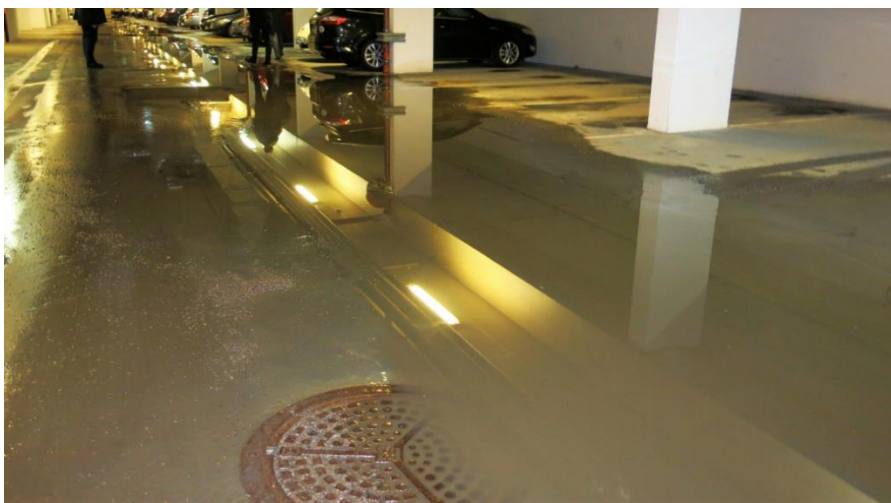
Figur 3.2. Vannansamling på betongdekke inne i garasjeanlegg (Sintef, 2018b)
