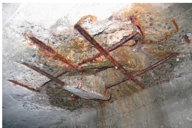
Figur 3.1. Skader på betongkonstruksjon som følge av armeringskorrosjon (Foto: Rambøll Norge AS)
