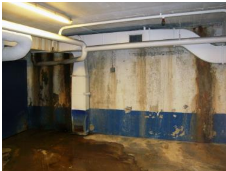
Figur 3.3. Fuktskader på betongvegg inne i garasjeanlegg (Norentrepenor, 2010)
