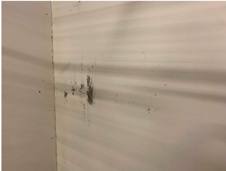
Figur 7.22. Viser maling som har flakket av betongveggen inne i bod nr. en (Foto: Emil Pettersen)
