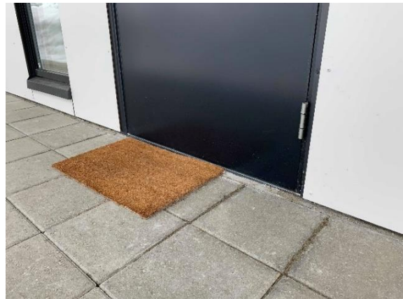
Figur 7.25. Lav terskel ved inngangsparti til leiligheter fra takterrasse (Foto: Emil Pettersen).
