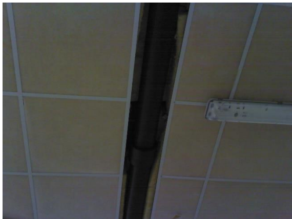
Figur 7.7. Fotografi av overvannsrør med manglende isolasjon omkring røret (Foto: Emil Pettersen)
