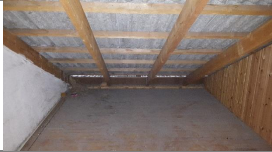
Bilde nr. 7 Loftsrom med luftespalte i raftekasse
