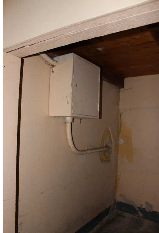
Bilde nr. 10 Inntaksskap for el
