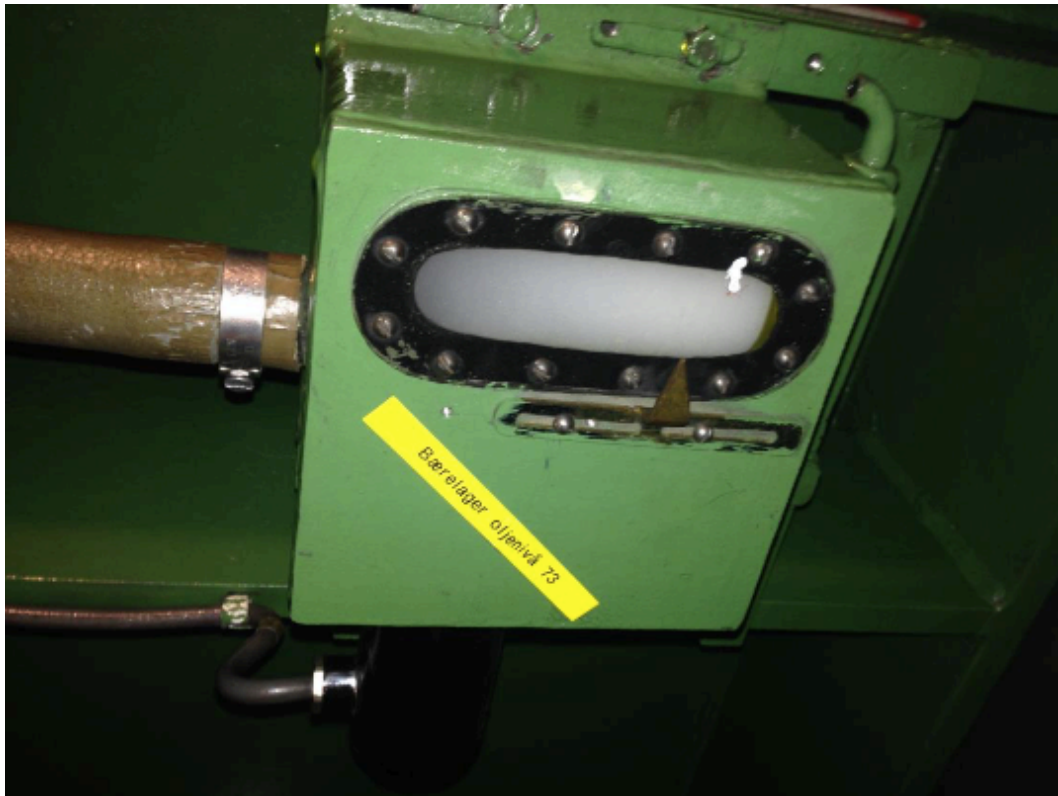
Figur 15: Lagerolje farget hvit av vannforurensing fra en defekt, intern lagerkjøler på øvre styrelager/bærelager i Fjone kraftverk. Bilde fra Tryggve Frøland i Skagerak kraft AS sin presentasjon "havari i lagerkjøler ved Fjone kraftverk".(55)
