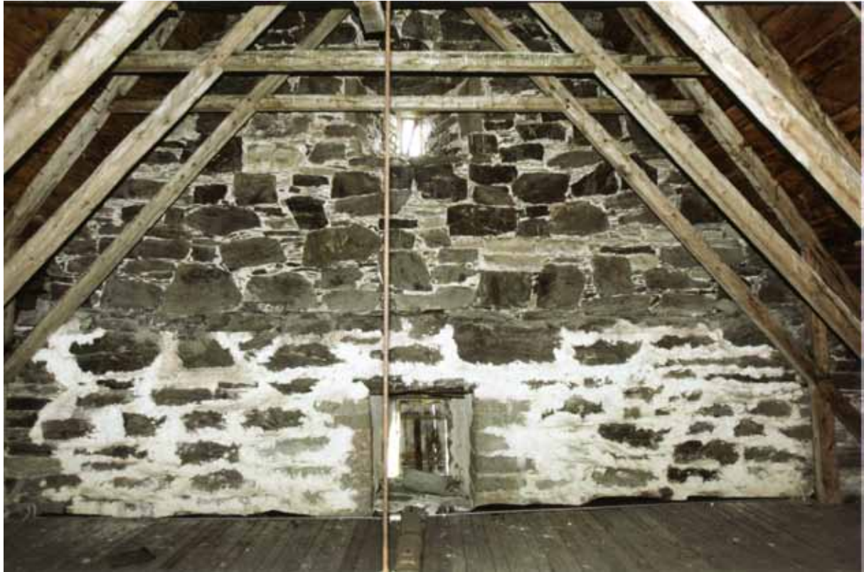
Trondenes kirke. Innerlivet av østgavlen i koret. Nederste del et murverk av romansk karakter, øvre del i gotisk murverk. Foto: Lars A. Oma. Kilde: Eide 2005.
