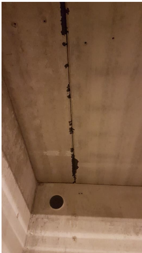
Figur 17. avtrekk i bod, fukt i tak?
