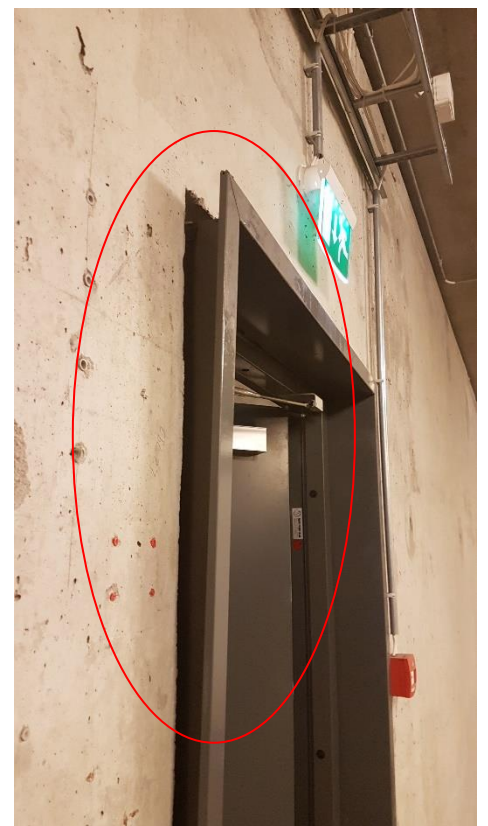
Figur 30. løs karm, branndør
