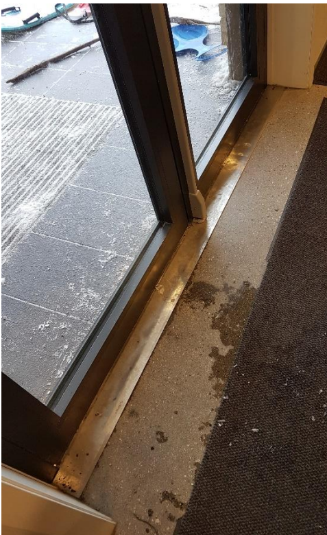
Figur 4. For tynt beslag, skadet. Samme beslag for alle ytterdører
