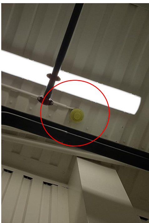
Figur 5. gult plastlokk på branddetektor anlegg ikke testet
