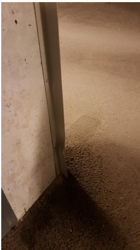
Figur 28. skadet karm brannport, fare for røykspredning
