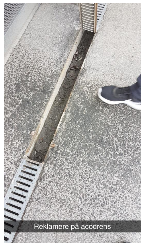
Figur 36. skadet opplegg som skal omstøpes
