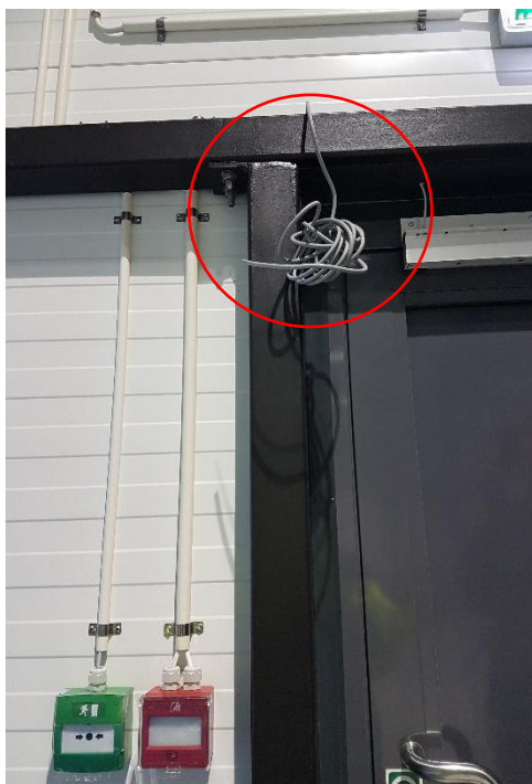
Figur 4. Rømningsdør ikke ferdigkoblet og testet
