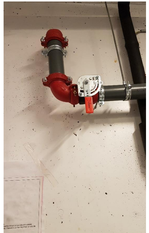
Figur 6. ventil skal ha reim og låses i åpen stilling
