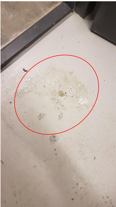
Figur 22. maling løsner, manglende dampsperre
