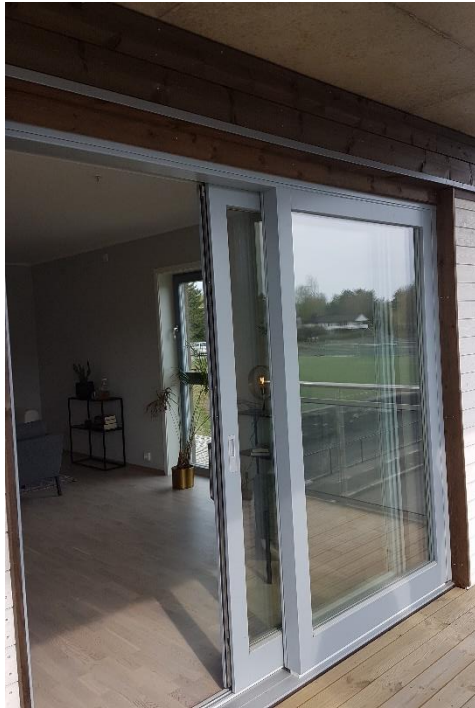
Figur 8. vannlekkasje over dør
