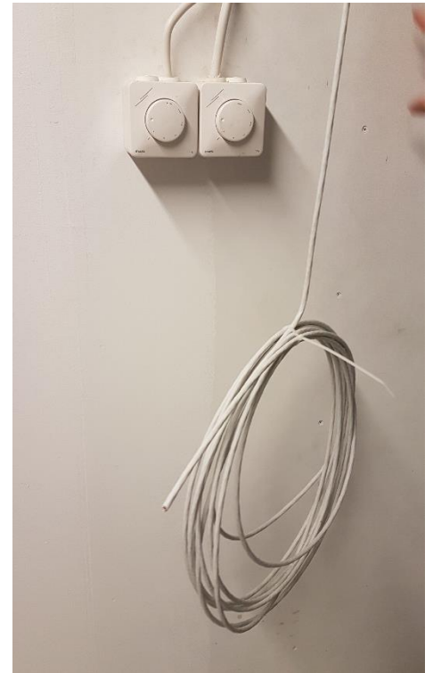
Figur 21. manglende kobling av kabel og manglende merking av brytere for ventilasjon av boder/fuktproblem
