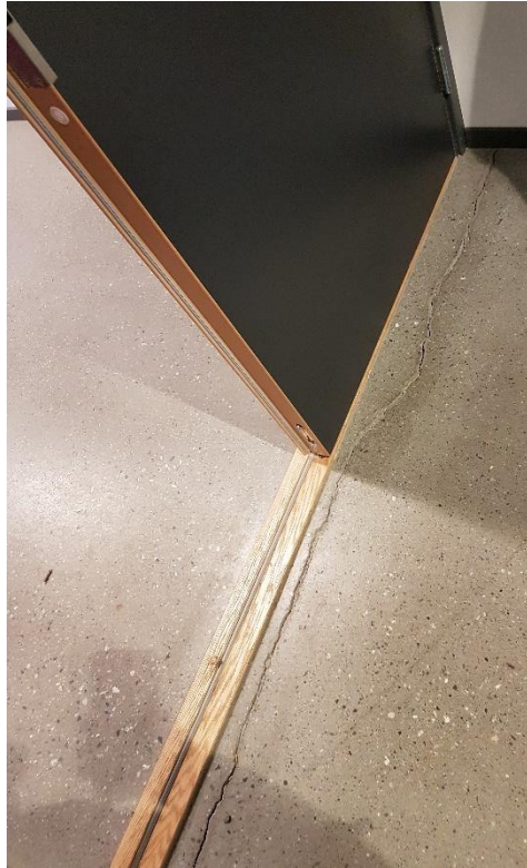
Figur 8. Skader gulv på grunn
