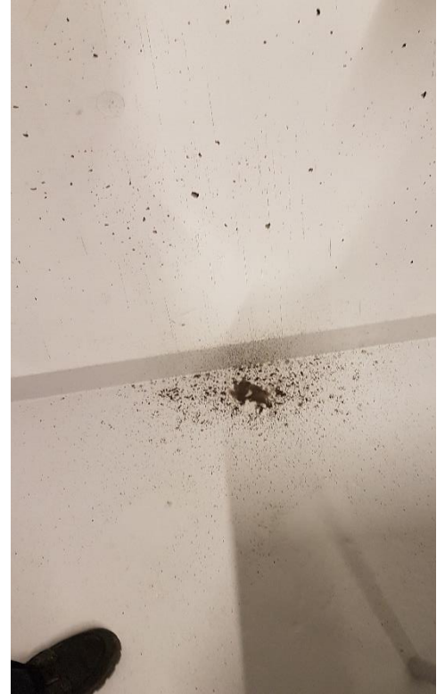
Figur 3. Vannlekkasje kjellervegg, skal være vann tett betong
