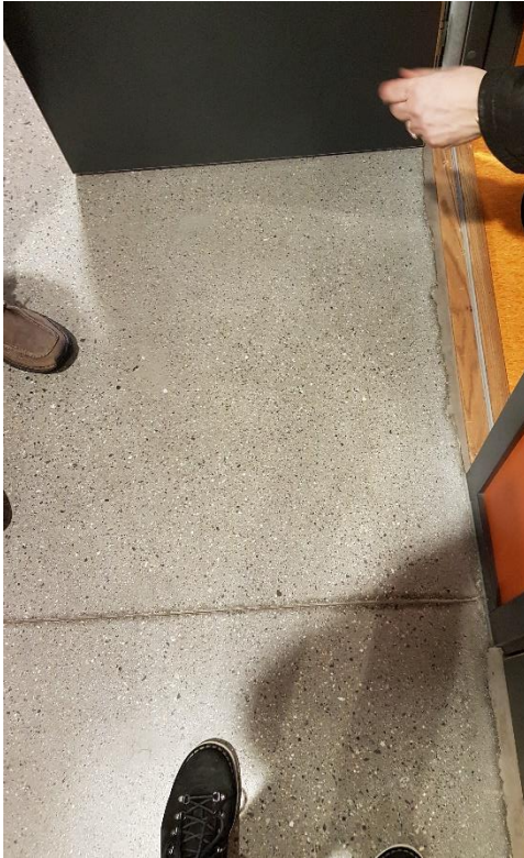
Figur 7. Skader i betong
