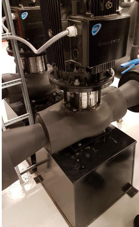
Figur 2. Beskrivelse ikke fulgt, rør må festes
