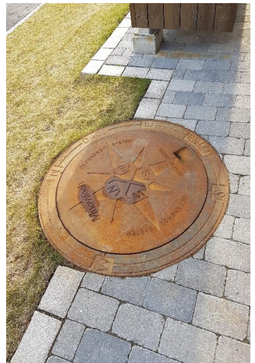
Figur 6. rust på kumlukk
