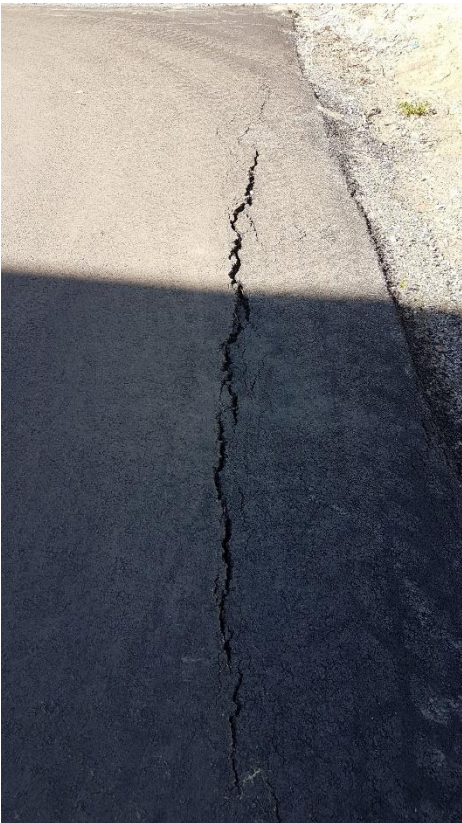
Figur 9. stort brudd i asfalt
