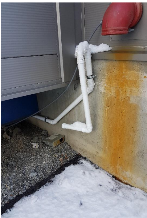
Figur 2. uteglemt at sprinkler må testes med vann, avløp tåler ikke frost
