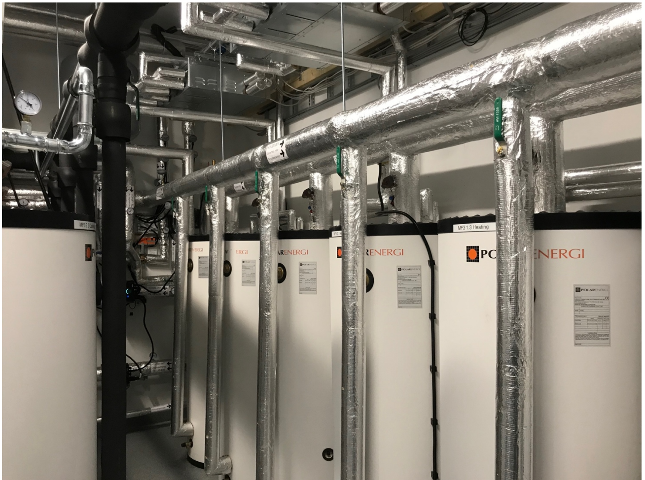
Figur 21: VP 380L tanker til kjøling. Bilde fra befaring av teknisk rom Thon Hotellet i Harstad 30.03.21.
