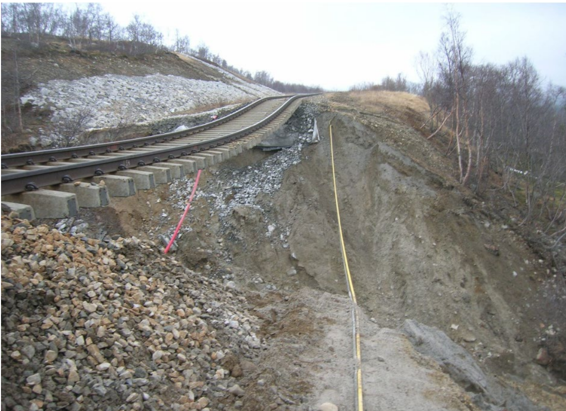
Figur 18. Fyllingskollaps Lønnsdalen 2010 Foto: JBV/Bane NOR
