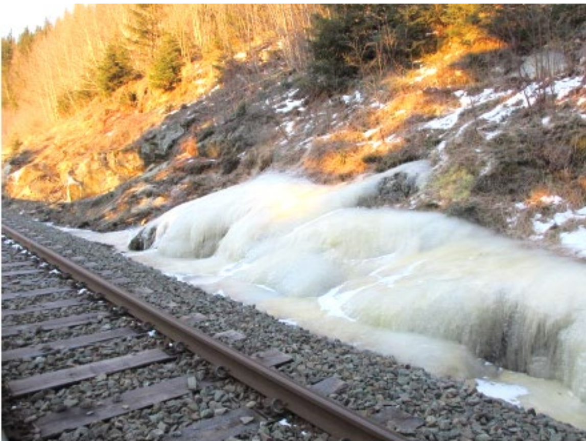
Figur 12. Slik ser det ut når det oppstår iskjøving fra grunnvann. Foto fra Meråkerbanen Foto: A.Liereng (Liereng, 2016)
