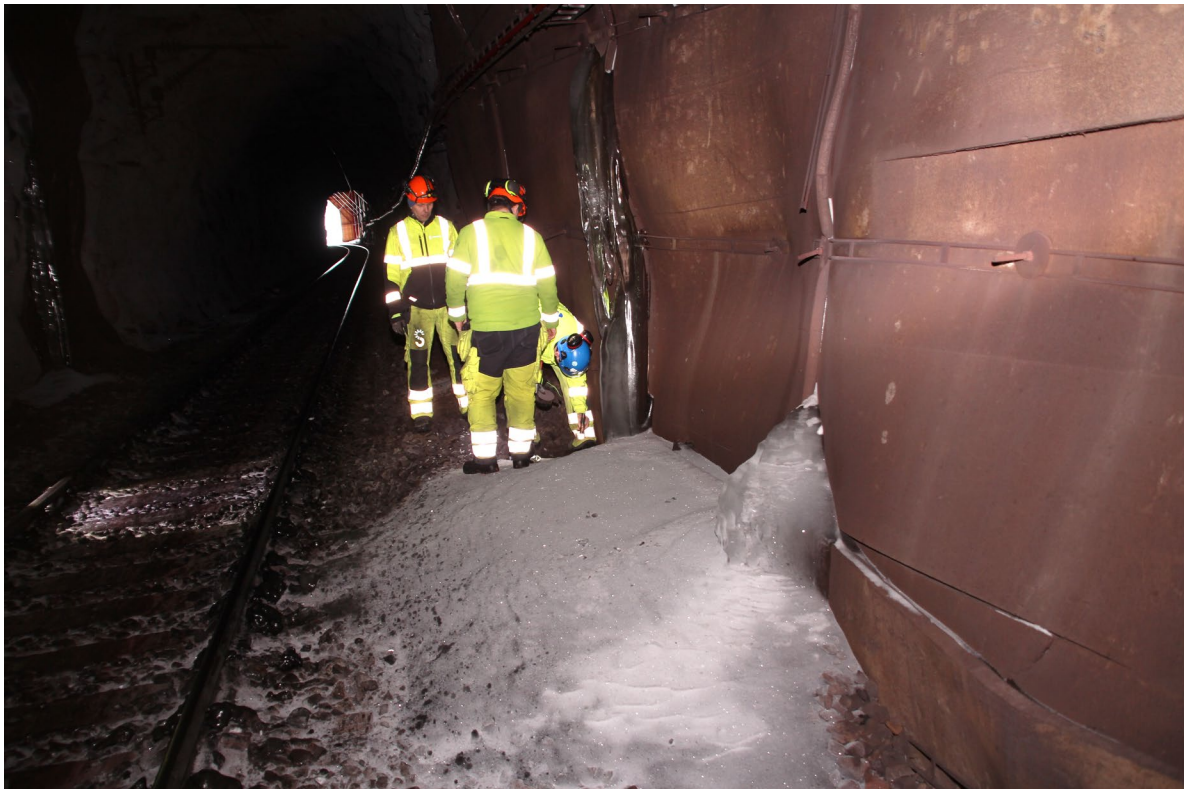
Figur 24. Iskjøving som følge av at grøft og drenering ikke tar unna, og skader på PE-skum Foto: Bane NOR v/Jon-Inge Fæster
