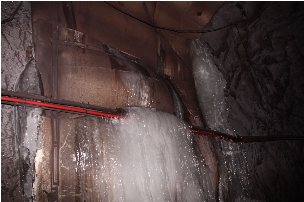
Figur 23. Ikke fungerende isolering av tunnellprofil på Ofofbanen. Foto: Bane NOR v/Jon-Inge Fæster
