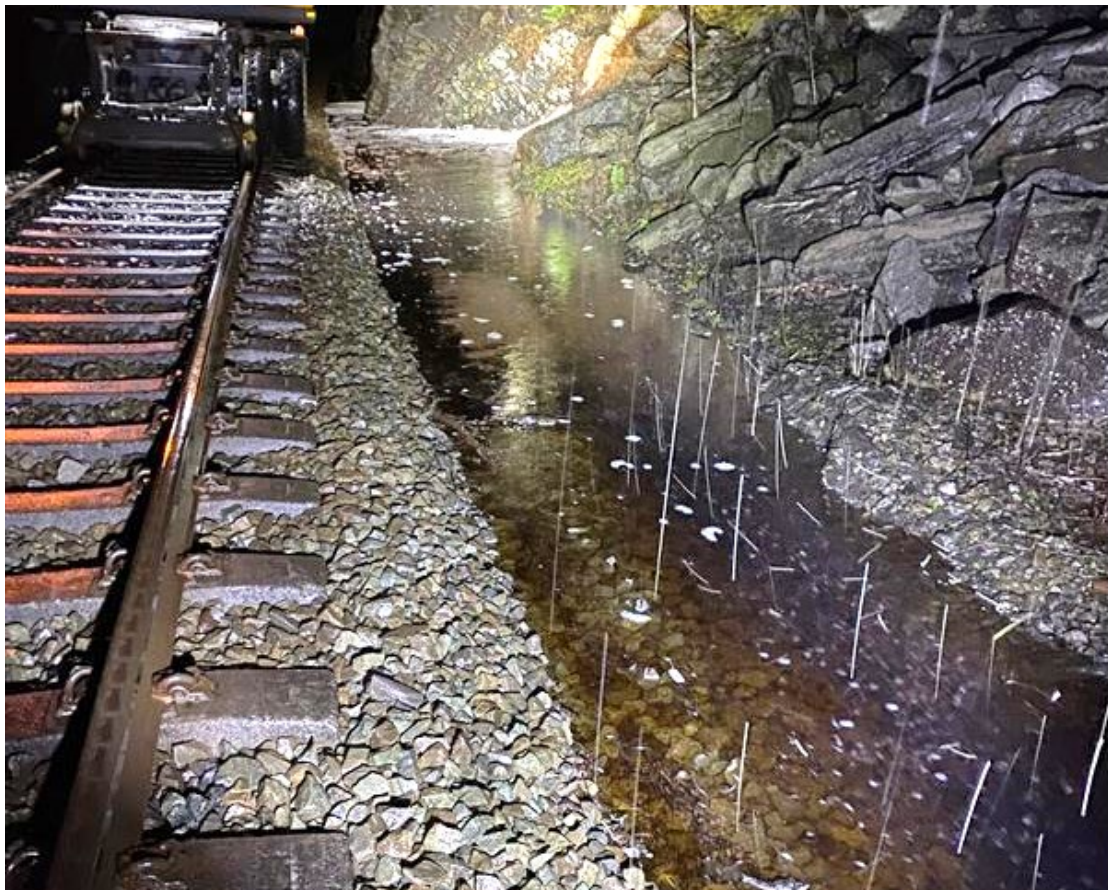
Figur 21. Linjegrøft som er oppfylt av vann som kan bli til is (Bane NOR SF, 27.04.2022)
