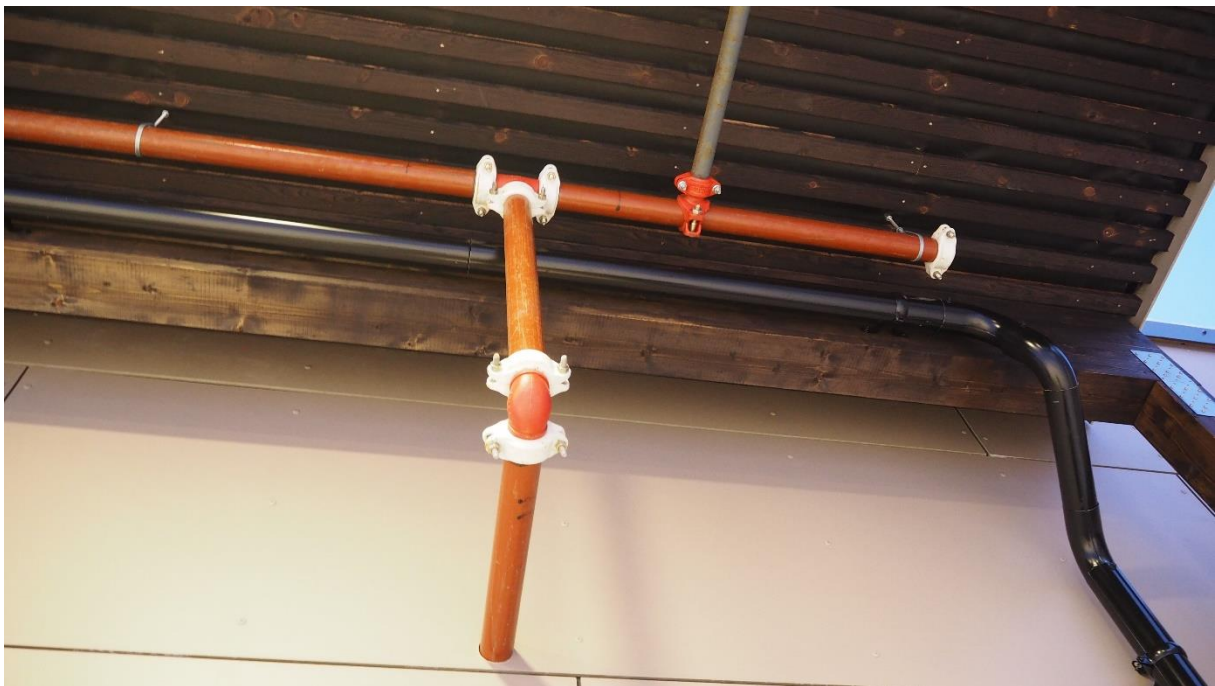
332 Installasjon for brannsløking med sprinkler
