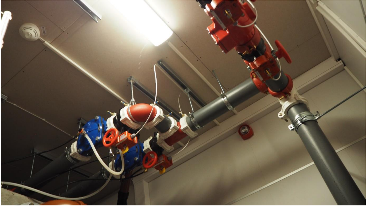
332 Installasjon for brannsløkking med sprinkler
