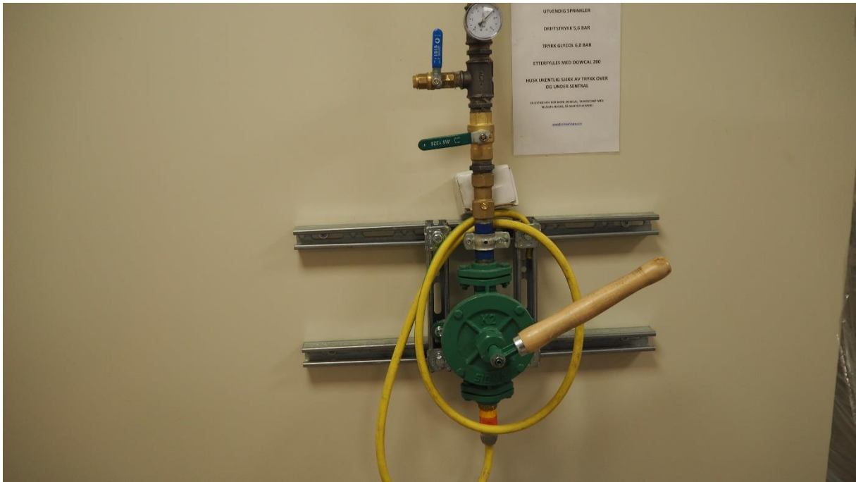
332 Installasjon for brannsløking med sprinkle
