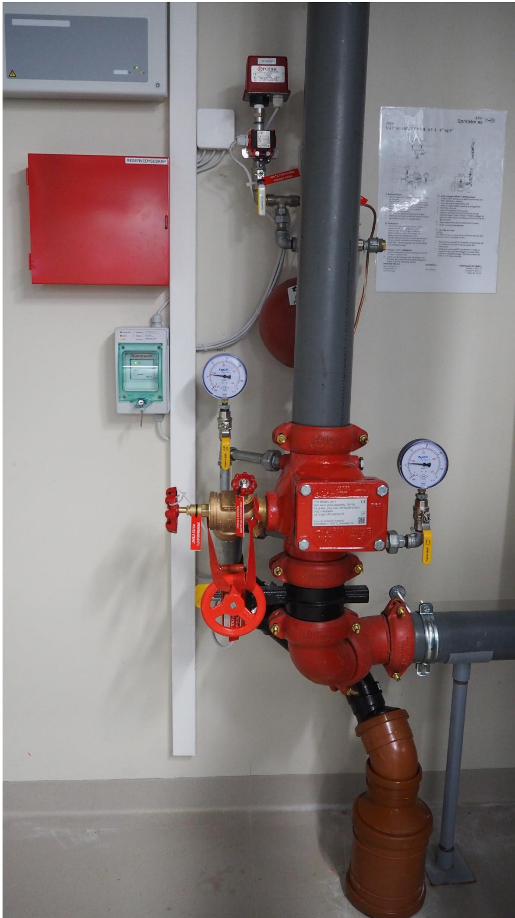
332 Installasjon for brannslukking med sprinkler-pumper
