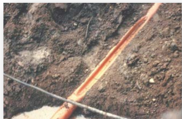
Figur 8 - Eksempel på avløpsledning som er deformert
