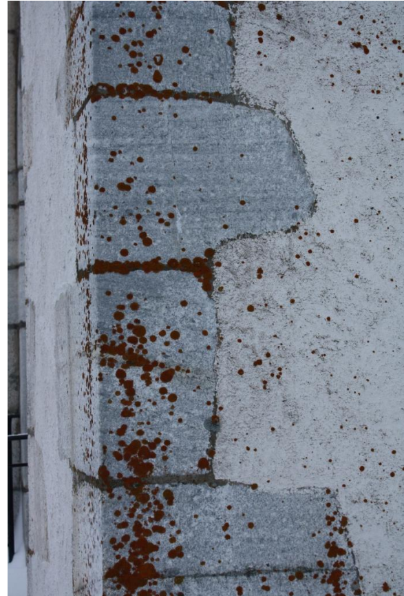
Figur 22 : Ibestad kirke. Murstein på hjørnet.
