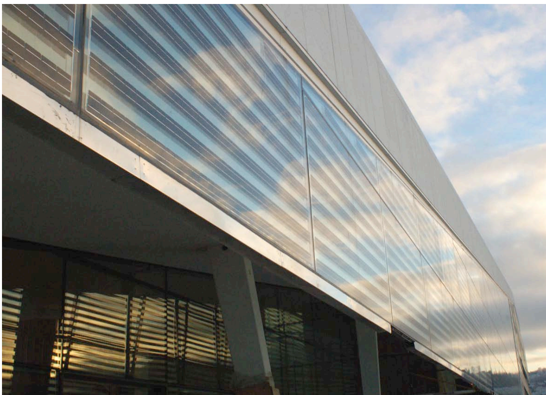
Ill. 6 Integrerte solceller i operabygningens glassvegger mot sør.
