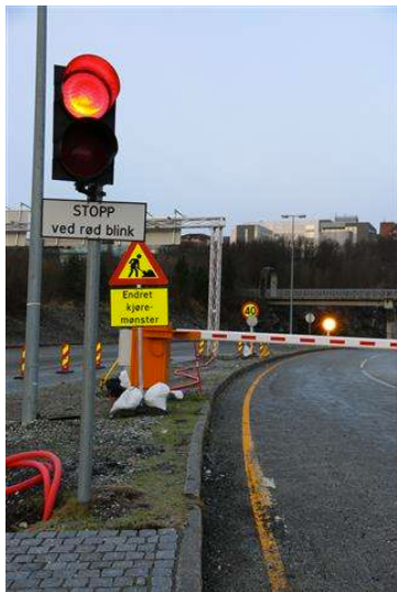
Figur 16 Lyssignal og bom for omkjøring under oppgraderingen i Tromsøysundtunnelen (Statens vegvesen, 2015)
