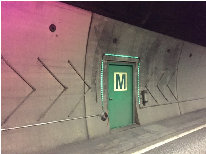
Figur 29 Eksempel på dynamisk LED-belysning i Oslofjordtunnelen
