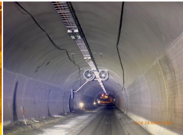
Figur 26 Brannventilasjon i T1, Tromsøysundtunnelen (Hansen, 2016)
