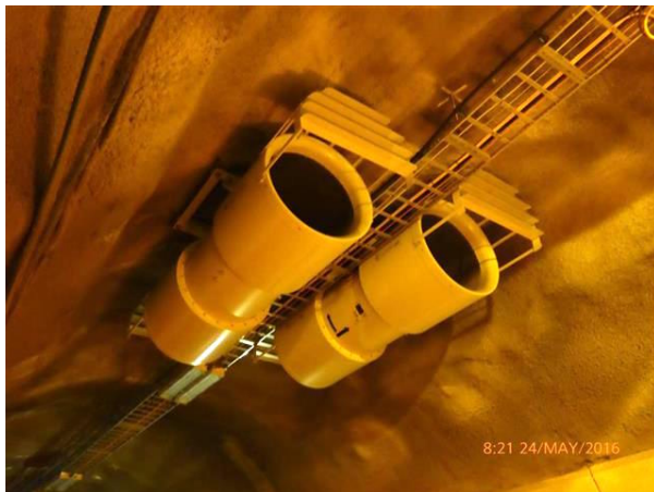
Figur 25 Ny brannventilasjon i Tromsøysundtunnelen (Hansen, 2016)
