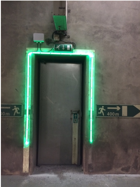
Figur 28 Nødbelysning i rømningsvei i Tromsøysundtunnelen (Robustas, 2016)
