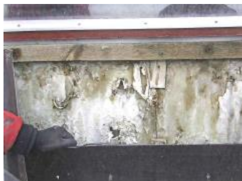
Figur 20 Kondensskader i yttervegg (Geving, 2011).
