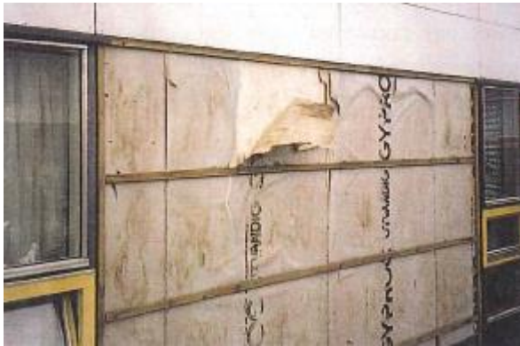
Figur 18 Vegg med plane plater hvor det har vært vanngjennomtrengning i fugene (Geving, 2011).
