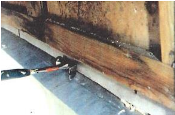
Figur 16 Fuktskader forårsaket av at den nederste horisontale lekten sperrer av for lufting og drenering (Geving, 2011).
