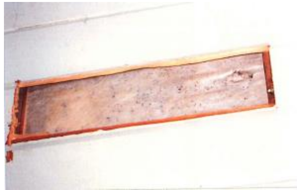
Figur 17 Muggsopp på vindsperre som følge av manglende ventilering og drenering (Geving, 2011).
